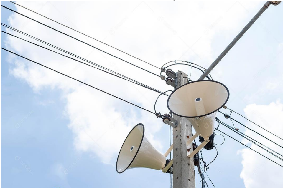
Foto 1: alto-falante em poste.
